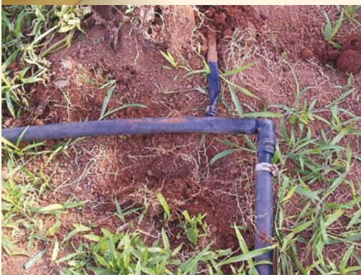
Trabalhos foram conduzidos com sistemas de irrigação localizada e por aspersão
